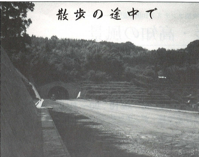
高知西トンネル、延長635メートル。高知西バイパス(高知市鴨部～伊野町渡川)のうち、高知市朝倉米田から伊野町枝川をつなぐ。枝川側では四国横断自動車道が交差し、やがて交通体系も一変、人々の生活はいま大きく変わろうとしている。高知西トンネル、平成8年度供用予定。
